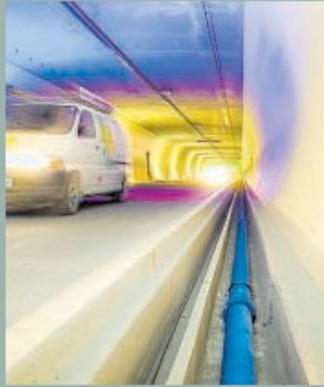
Löschwasser im Bosrucktunnel
